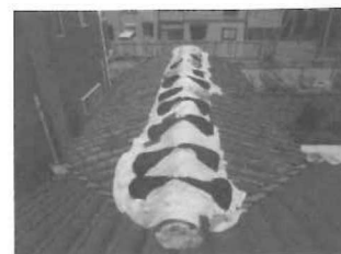
写真-7 破損屋根
